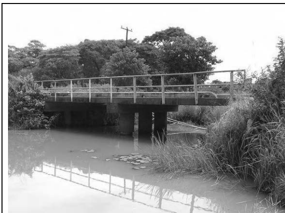
Chamakuwa 橋梁 1車線、損傷激しい(架け替え要請があがっている)。
