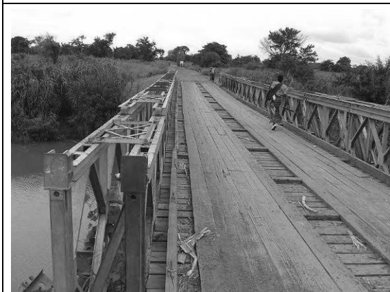
Lifyodzi 橋：下部工の洗掘で橋梁が壊れ、仮設ベイリー橋を使用(要請済み)。
