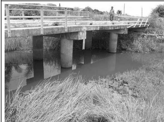
Kanjamwano 橋：老朽化している（要請済み）。
