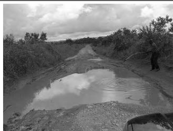
同左大きな水溜まり(深さを確認している)。
