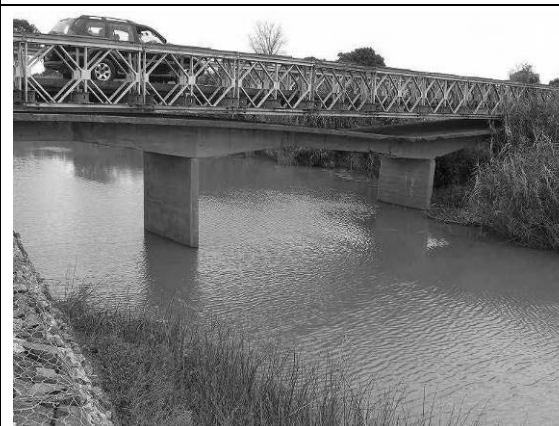
同左：既設橋梁の損傷状況がよく分かる。
