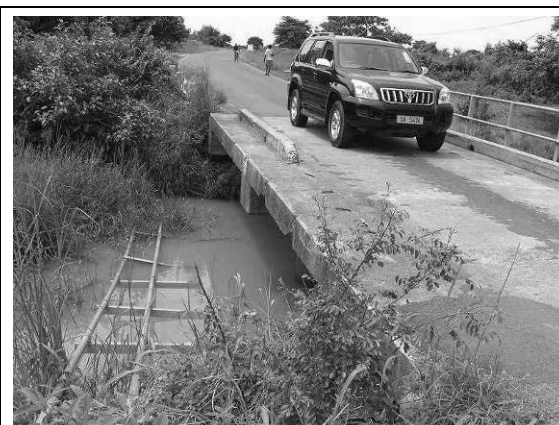
Ling'ona 橋梁 損傷が激しい(要請済み)。
