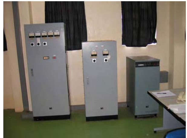
写真-4: 定電圧電源装置
