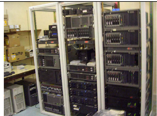
手狭なサーバー室
