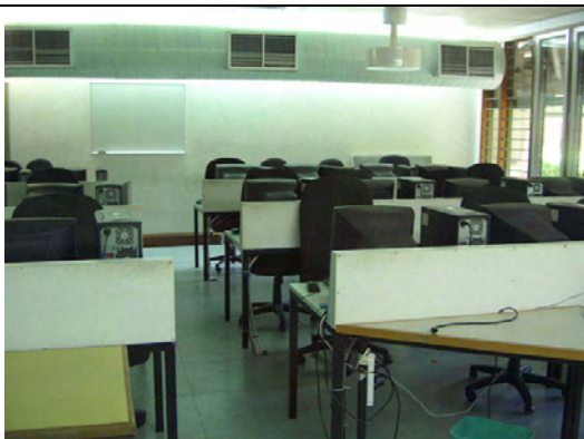
プロフェッショナル実習室(写真の空調設備は故障)
