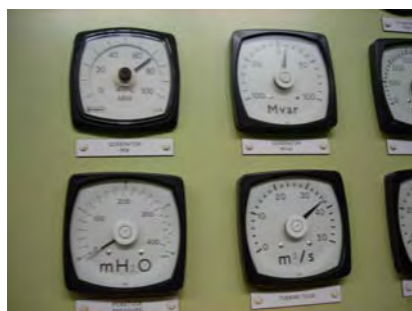
写真 12 発電所運転状況(No.3)
