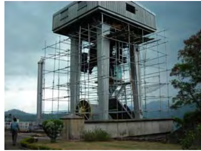
写真 6 取水口ガントリー
