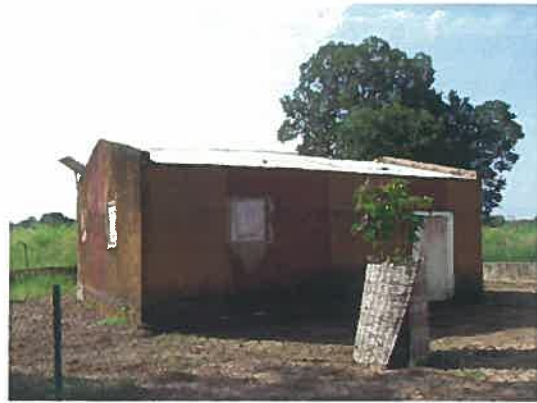
老朽化した入院施設
