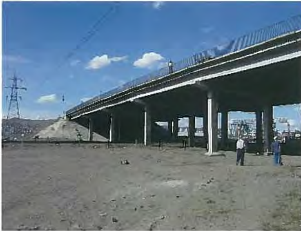
グルバルジン橋：南西方向から撮影。上部工のみ架け替え予定。
