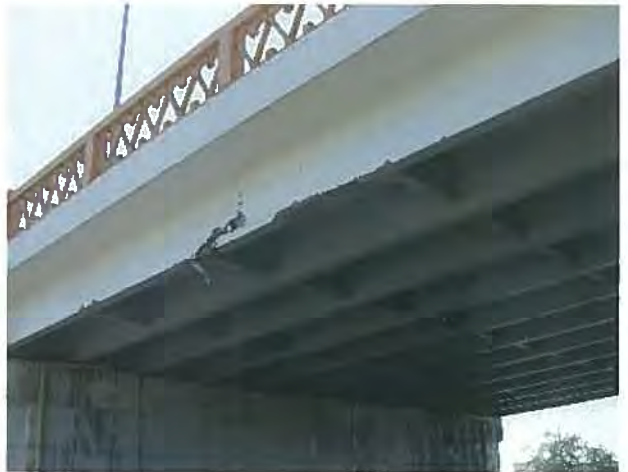
平和橋：南端においてクリアランスが4.2m。補修後大型車が主桁に衝突したと思われる。
