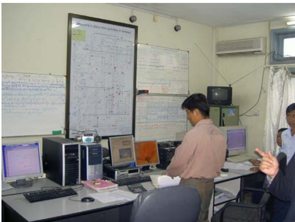
EDC給電指令所
