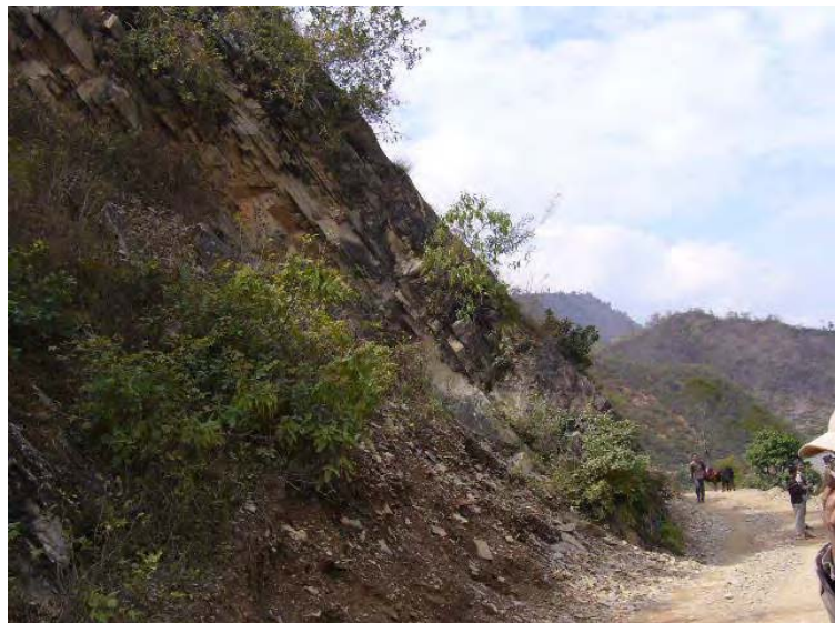
写真 G-4 STA.23+300 付近の斜面崩壊（流れ盤）
