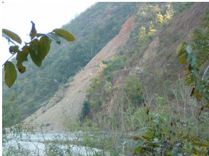
写真 G-3 STA.14+850 の斜面崩壊
