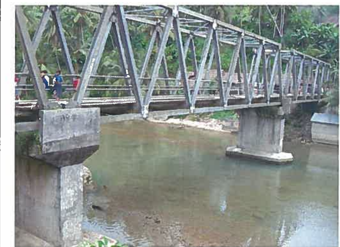
Mezaya 橋：両橋脚とも河川によって洗掘されている。
