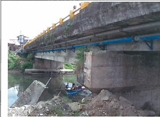
Nou 橋：地震により側径間が上流側へ移動している。 この橋の下は漁船が頻繁に航行している。
