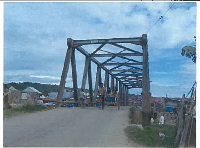
Nou-A 橋：下流側の橋台が沈下している。 幅員が狭いため一方向の交通となっている。
