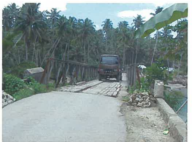
Sa'ua 橋：下部工は丸太で仮補強されているが、今にも落橋すると思われるほど危険な状態である。
