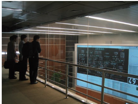
新 SCADA システム
