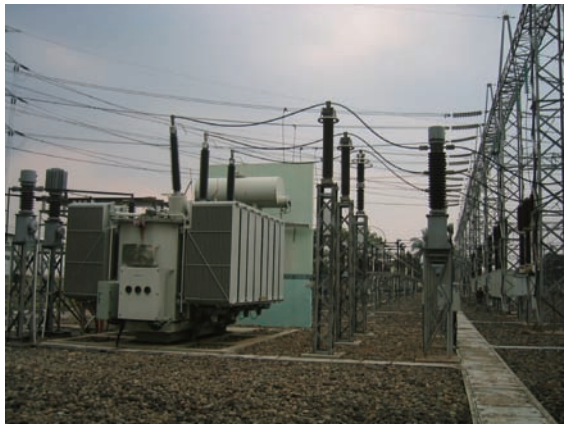
150/20kV 変圧器 (この 2 次ブッシングまでが P3B 資産)
