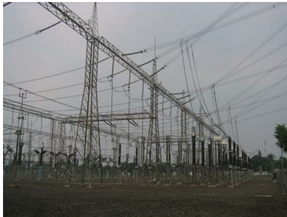
500kV 引き込み鉄構
