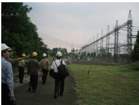
150kV 引き込み鉄構
