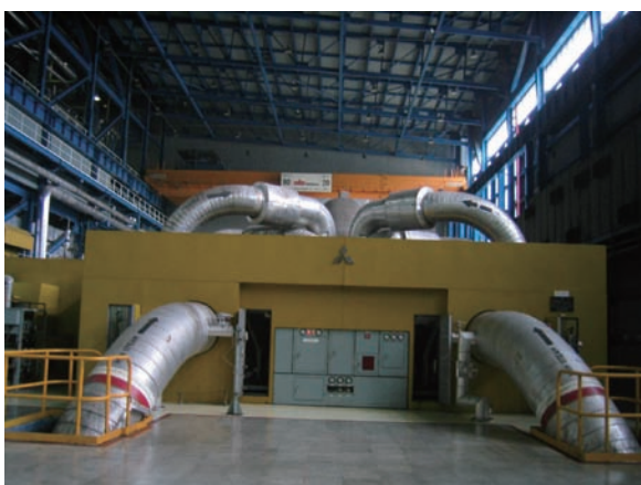
5号機 タービン発電機 600MW (タービン：三菱重工、発電機：三菱電機)
