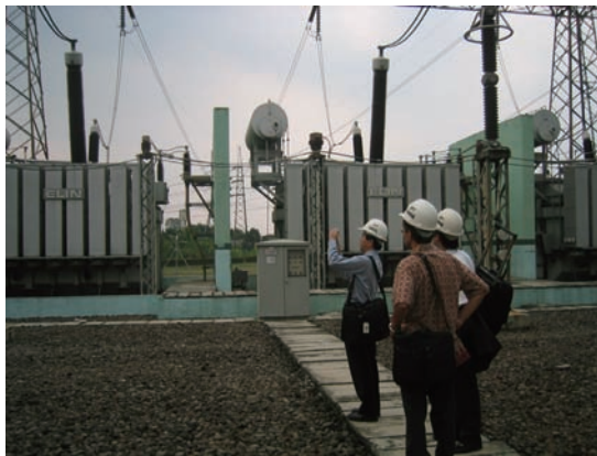
500kV/150kV 500kVA 変圧器 (ELIN 製)
