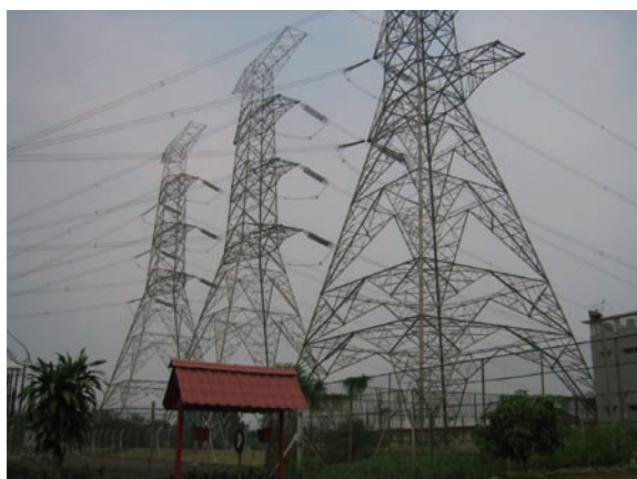
500kV 引き込み鉄塔
