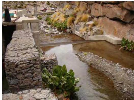
堰（H1.5m, W6m）の上流河床部には土砂が堆積しており、取水口（左下）が十分機能していない状況である。
