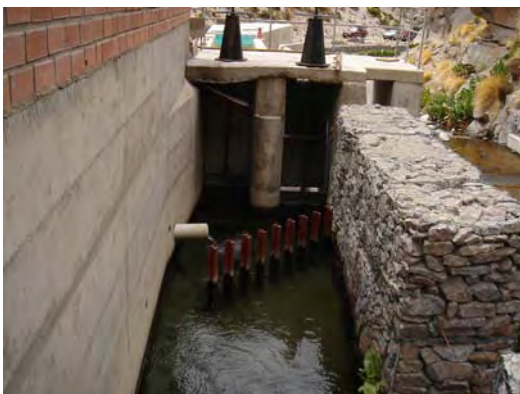
取水ゲートの台座、護岸工、鋼製ゲートの改修等が必要である。
