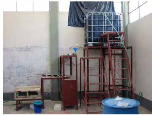
既存サンファン配水池内の塩素注入装置
