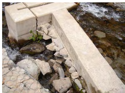
流量観測用として設置された三角堰の基礎工部分。機能していないためサンファン川の流量観測データは存在しない。
