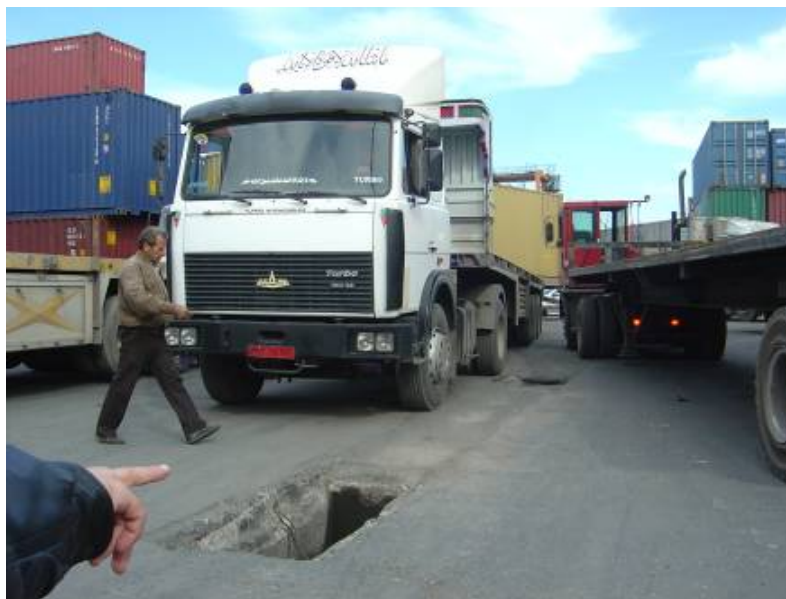
写真 2-16 路面の損傷状況
