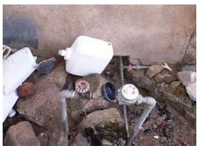
給水管及び給水メータの状況 (Singida)
