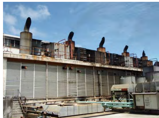
老朽化した発電所 (騒音・振動問題あり)
