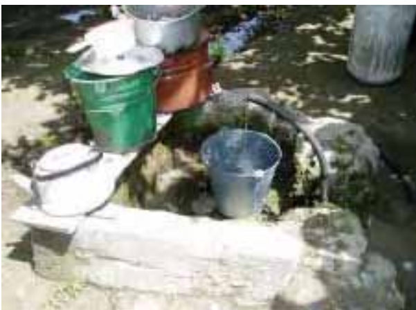
写真-5 【モスクワ町の各戸給水栓】 民家の敷地内の各戸給水栓。蛇口のついていないもの、壊れているものが多く、通水時は垂れ流し状態である。井戸ポンプの運転時間は朝夕2回で計12時間/日である。水压は低い。
