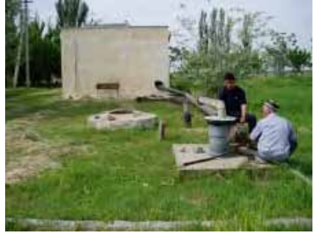
写真-8 【メハナタバッド・ジャモアット、メハナタバッド村】 井戸2本の内の1本。現在使用中であるが、1961年建設で老朽化が進んでいる。本井戸サイトから、メハナタバッド村近隣の計6村(人口19000人)に給水を行なっているが
