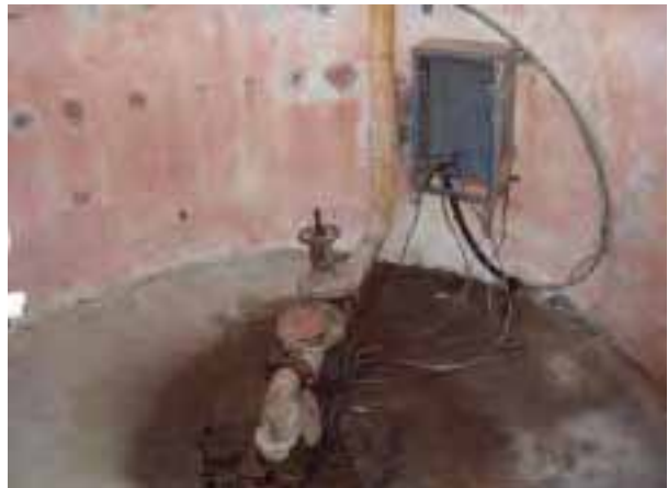
写真-2 【モスクワ町ボドカナル深井戸】 40年以上前の旧ソ連時代に建設された深井戸。 4井の中の1井戸で老朽化が進んでいる。ポンプ故障のため、4井戸中2井戸は停止している。
