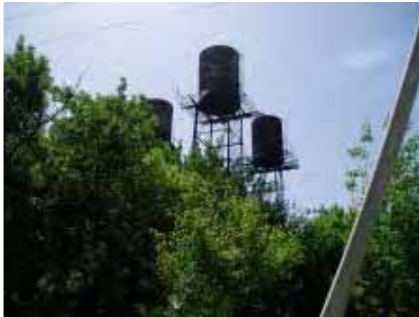
写真-9 【メハナタバッド・ジャモアット、メハナタバッド村】 高架タンク25m 3 。4基あるが老朽化し漏水があるため、その全てが使用されていない。
