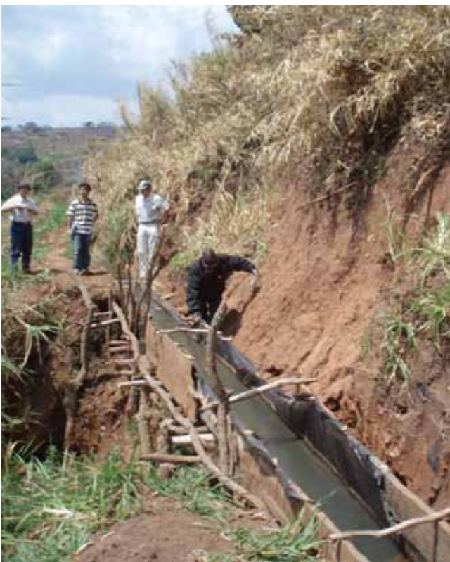
地すべり発生地域にもかかわらず設置された水路
