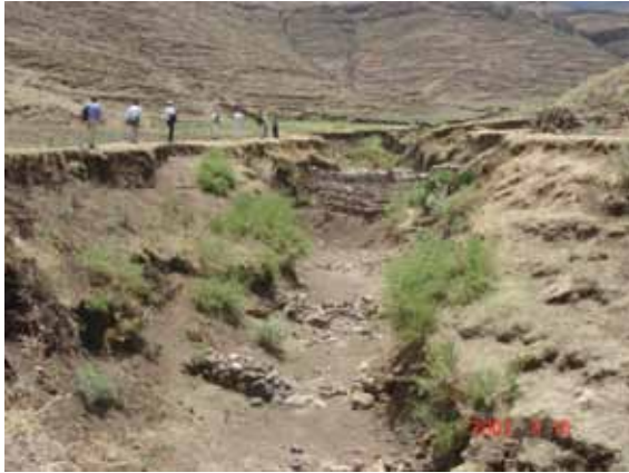
土砂に埋まったチェックダム
