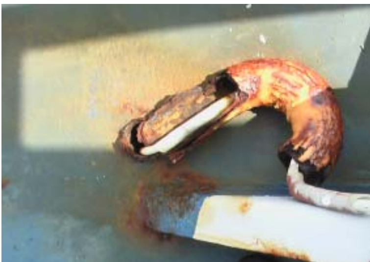
ブリッジ頂部甲板の貫通パイプ損傷 このような場所がたくさんあり、頻発する雨漏りの原因となっている
