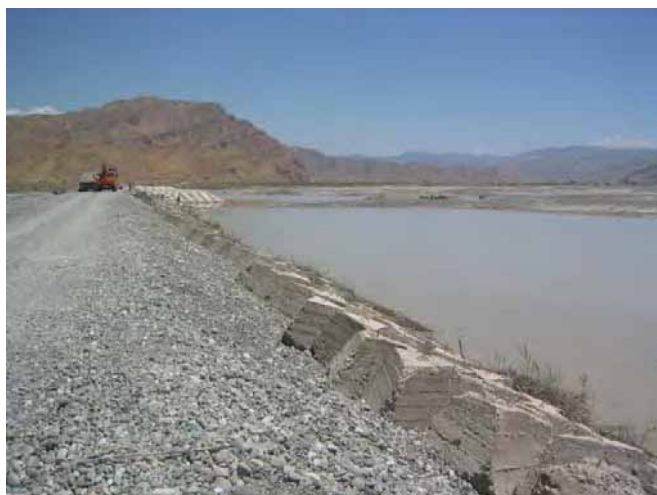
До смыва крепления откосов на репере 2.8км (Май 2007)
