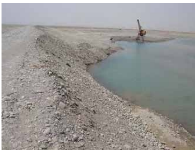
Точка просачивания на репере 3.8км (Август 2006)
