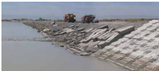
До смыва крепления откосов на репере 2.8км (Май 2007)
