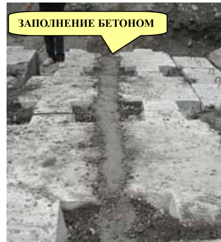
Заполнение пустоты между бетонными кубиками на Ш2 (20 марта 2007) * Дата съемки в скобках
