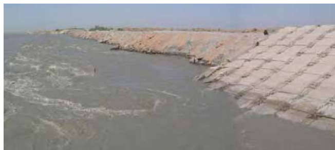
После смыва крепления откосов на репере 2.8км (Август 2007)
