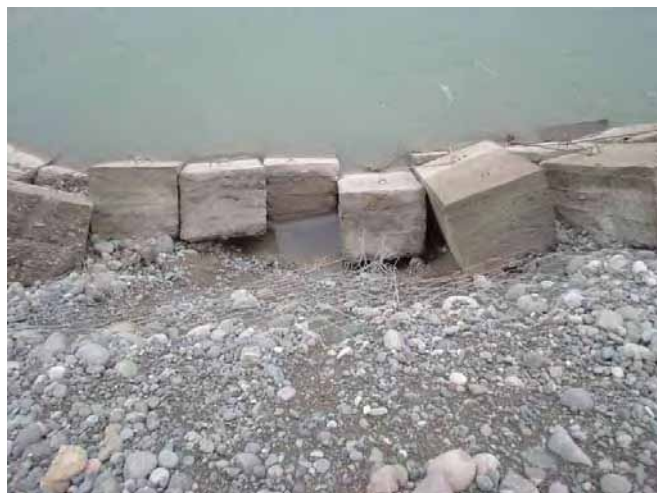
Разрушенный габион на репере 8.2км (Декабрь 2006)
