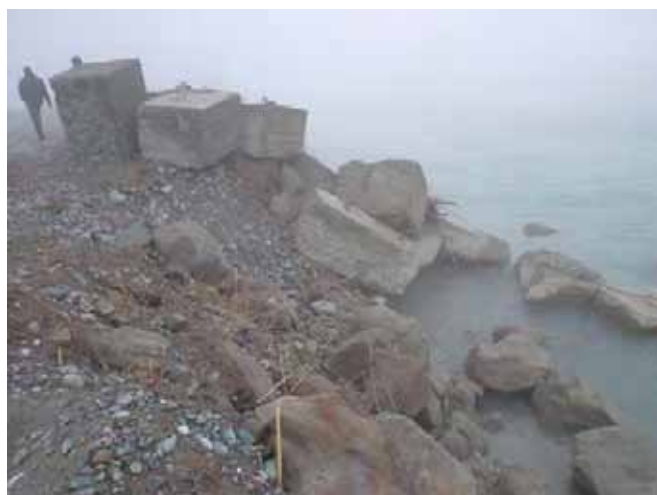
Временный монтаж бетонных кубиков и булыжных камней для защиты от береговой эрозии на репере 10.3км (Декабрь 2006)
