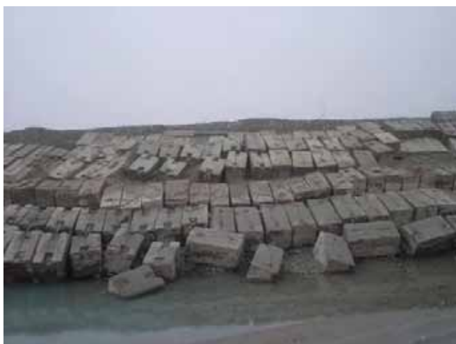
Размыв русла реки и неправильный бетонный кубик на репере 2.6км (Декабрь 2006)
