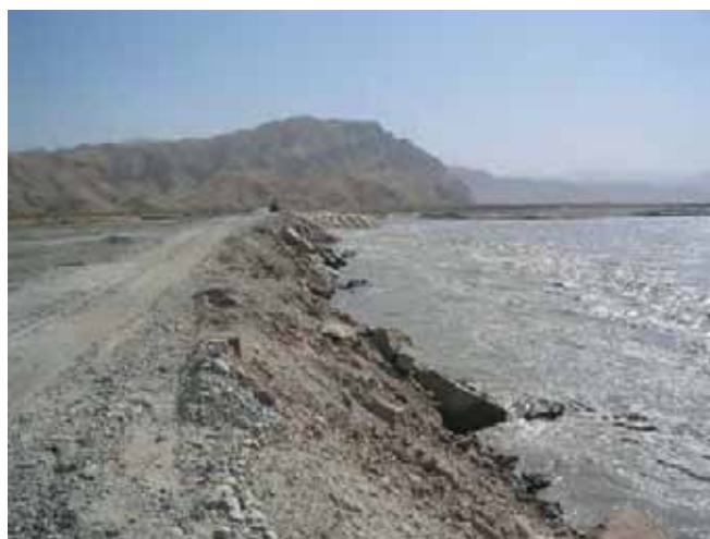
После смыва крепления откосов на репере 2.8км (Август 2007)
