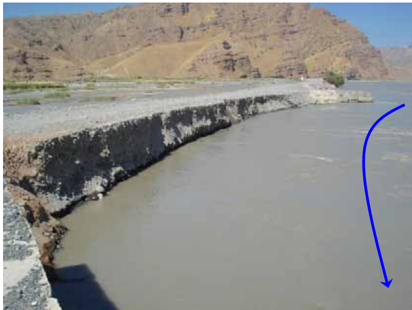
Рис. R 11.4.7 Разрушение направляющей дамбы катастрофического сброса (около 1.0км)
