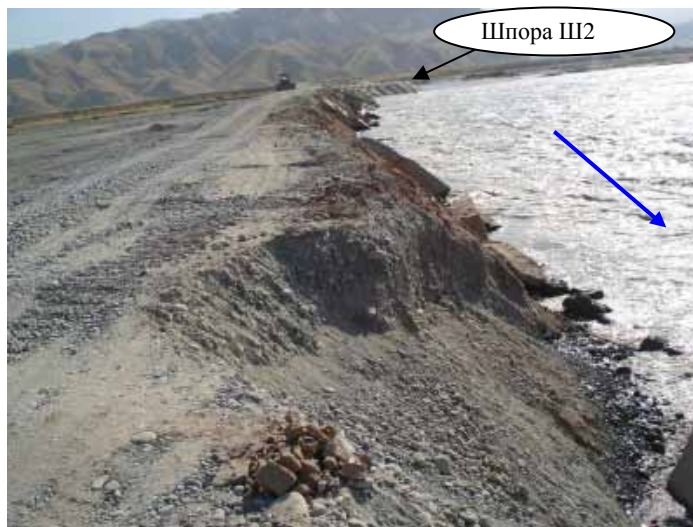
Рис. R 11.4.5 Разрушение основной дамбы 2 (Вниз по течению, 1 августа)
