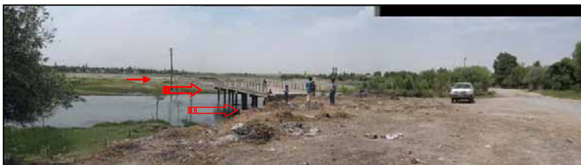
Паводок размыл материалов насыпи на обеих сторонах моста, ширина - 474.0 м.
