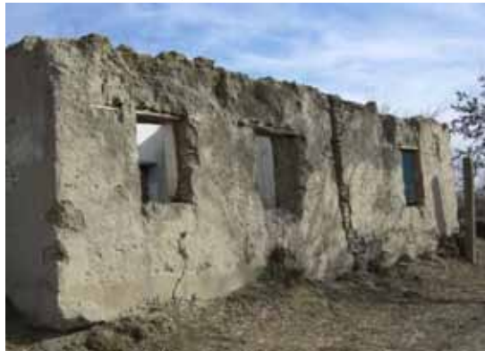
Полностью разрушенный дом
