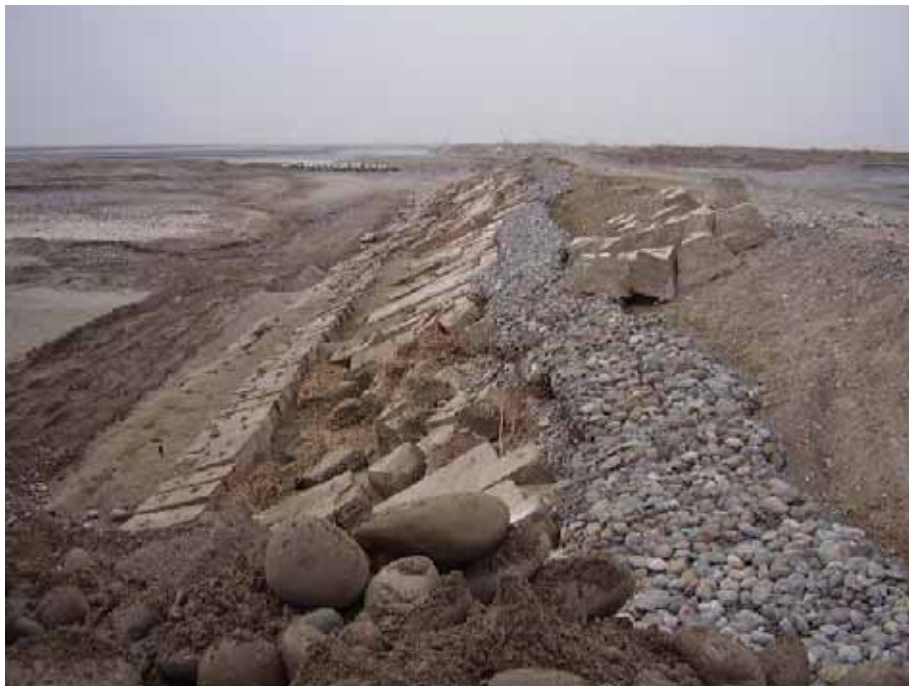
Рис. R.7.3.2 _____ Повреждение дамбы и разрушение бетонных кубиков на нем (берег реки)
