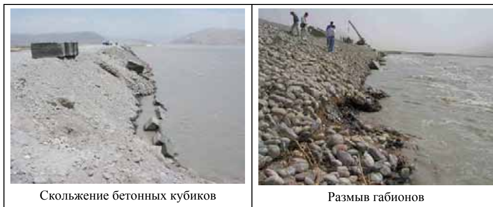
Рис. R.2.5.3 Разрушение существующей дамбы
