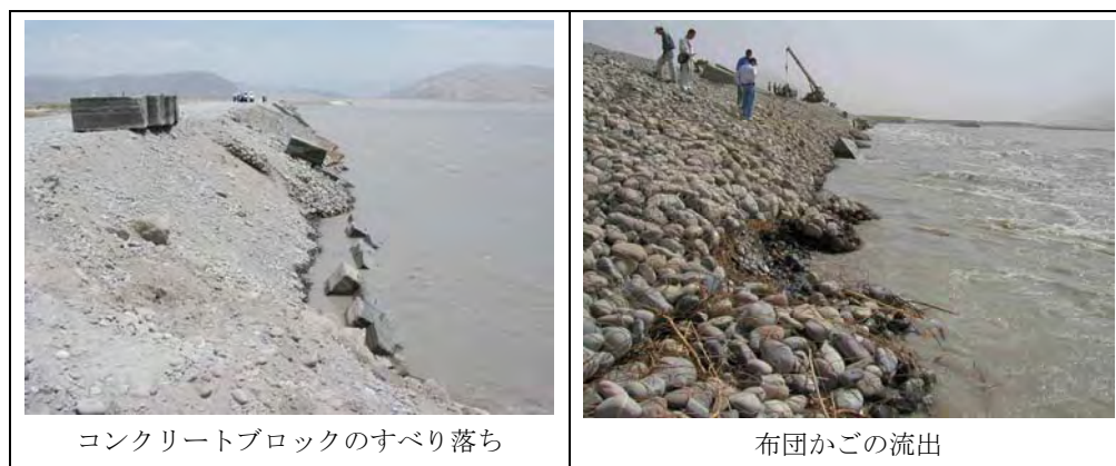
図 R.2.5.1 既設堤防の破損状況
