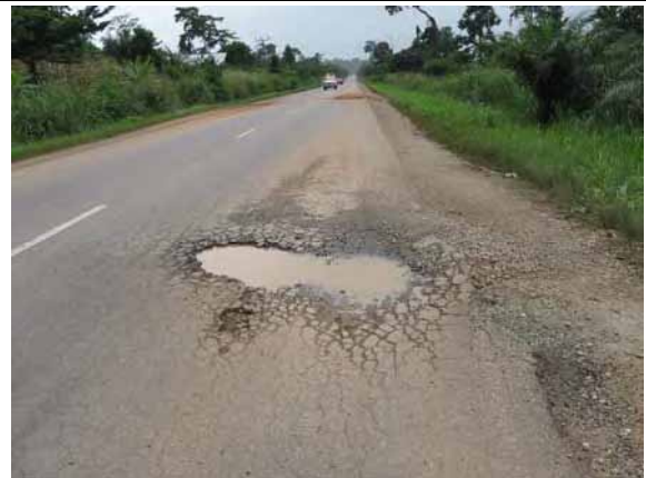
写真 2-4 道路損傷状況
