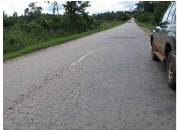
写真 2-2 道路損傷状況
