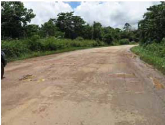
写真 2-3 道路損傷状況
