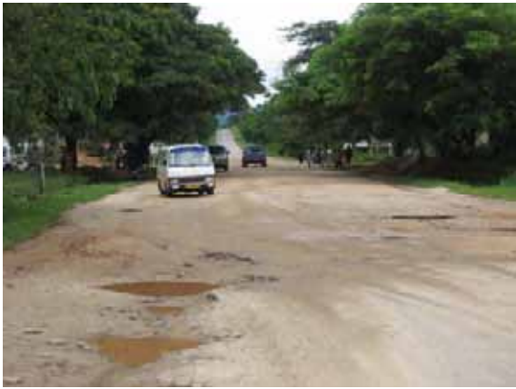
写真 2-1 道路損傷状況
