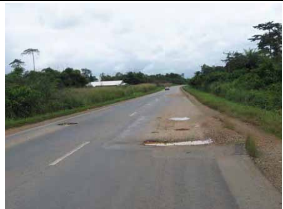
写真 2-6 道路損傷状況
