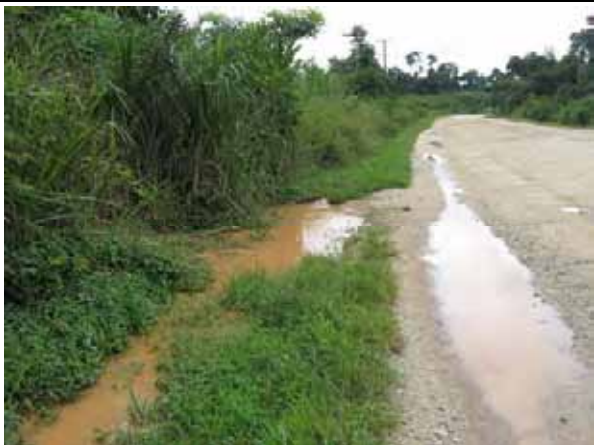
写真 2-5 道路損傷状況
