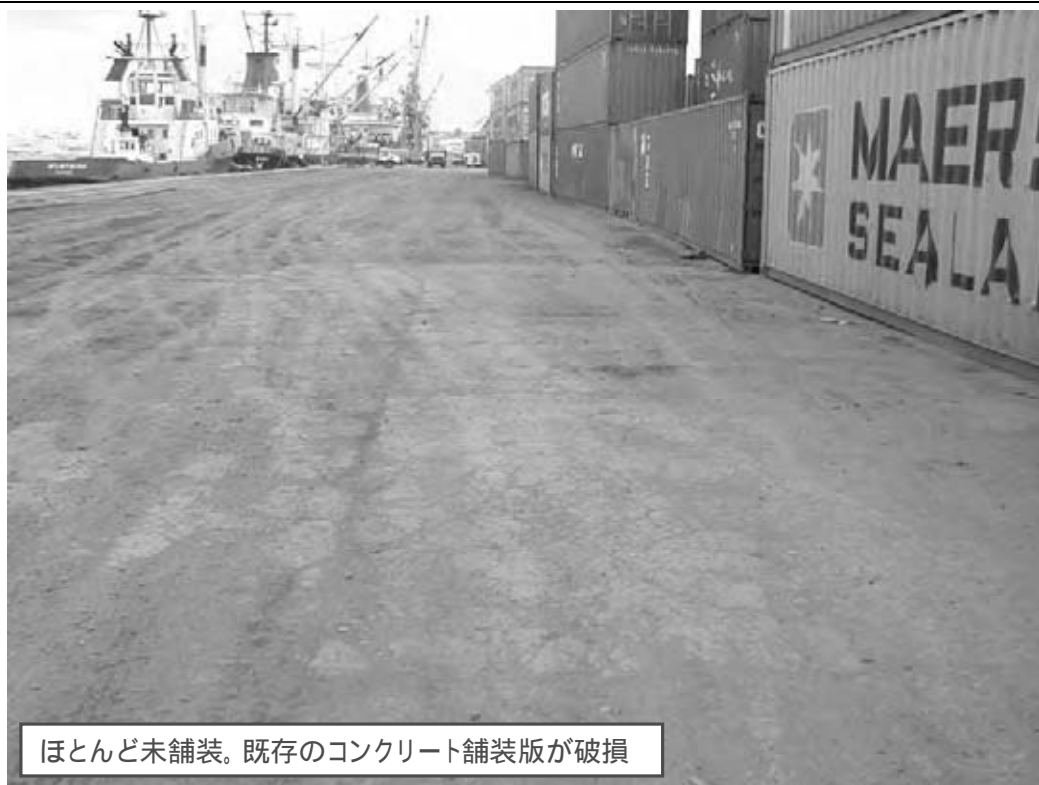
写真 - N10 No.3A 岸壁のエプロン
