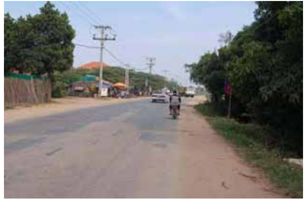
Sta. 5+000 路面表層の損傷状態が著しい
