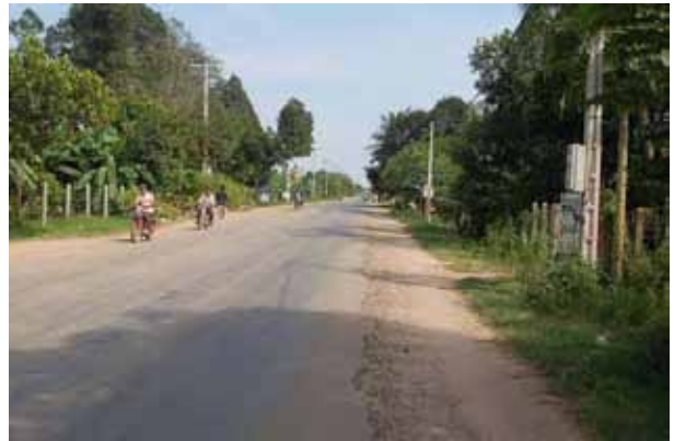
Sta. 9+000 路肩の損傷状態が著しい
