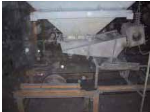
(Ленточный конвейер на ПМ № 6)
