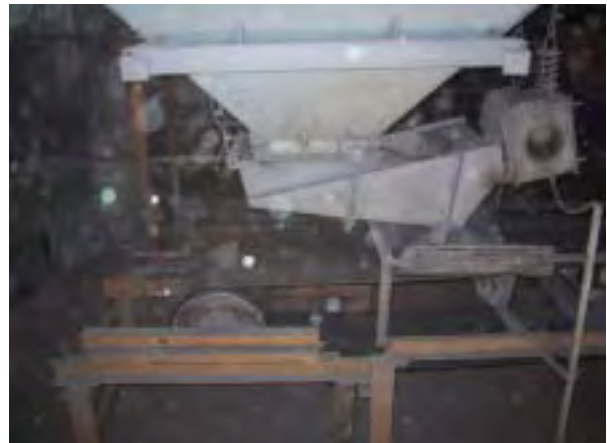
(Conveyor belt at TTP No. 6)
