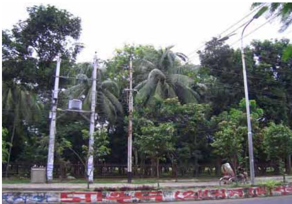
建設予定地の前面道路の電力引込電柱
