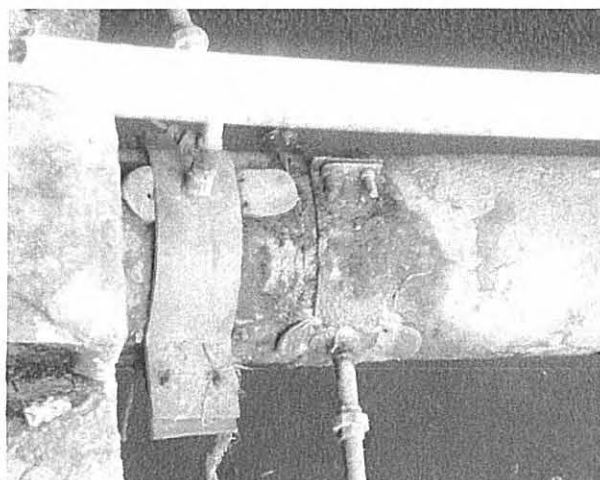
ゴム草履をパッキング材とした接続
