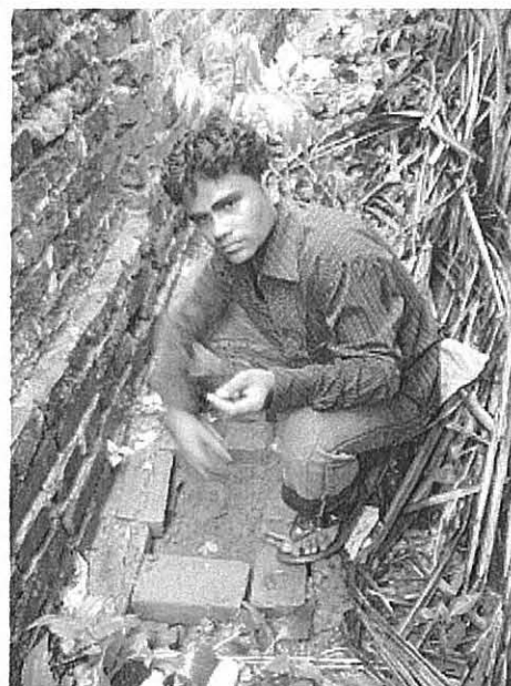
公共栓のメータ (砂の下になっており日常的に確認されていない)
