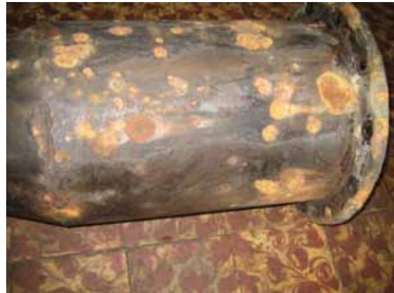
⑪ シャフト保護管の凹み。シャフト保護管は、テーパ溶接部からオイル漏れがあり、表面に深い傷があるため要交換。（アビレス・サンパロック排水機場）
