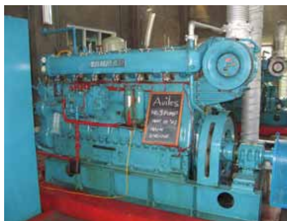
③ 油漏れ、空気漏れが激しく主ディーゼルエンジンの故障が発生している。（アビレス・サンパロック排水機場）
