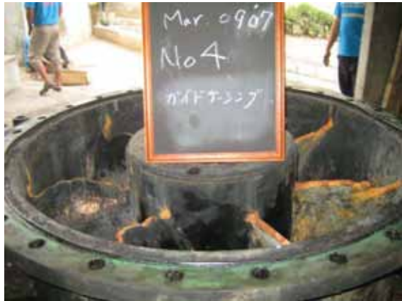
⑩ ガイドケーシングは、10cm 程度の欠損が見られ要交換。（キアポ排水機場）
