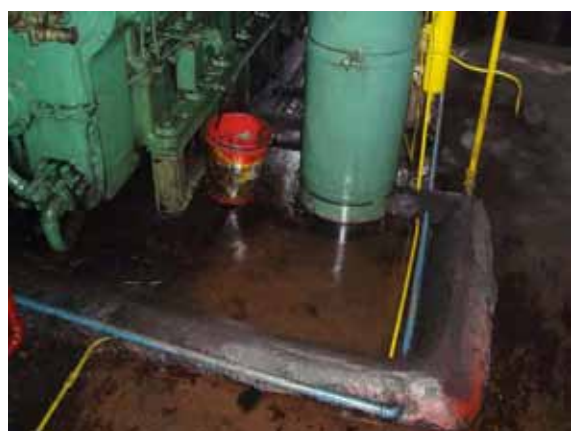
④ 土手を作り油漏れの拡散を防がなければならないほど、エンジンからの油漏れが激しい。（トリパ・デ・ガリナ排水機場）
