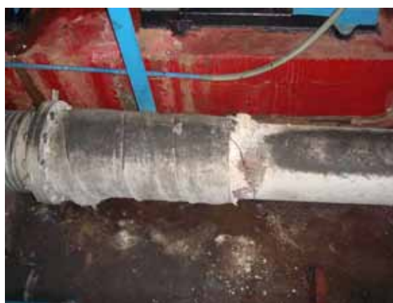
⑤ 排気管の耐熱カバーが完全に外れ、作業員が火傷を負う事故が発生している。（トリパ・デ・ガリナ排水機場）
