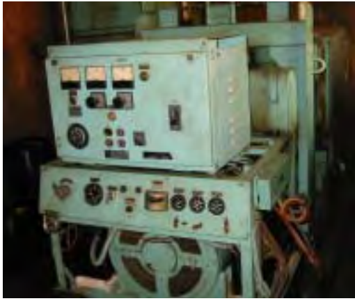
既存自家発電機
