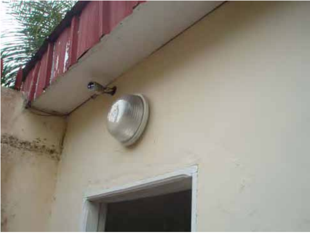
警備室入口上部の監視カメラ 敷地右側をカバー
