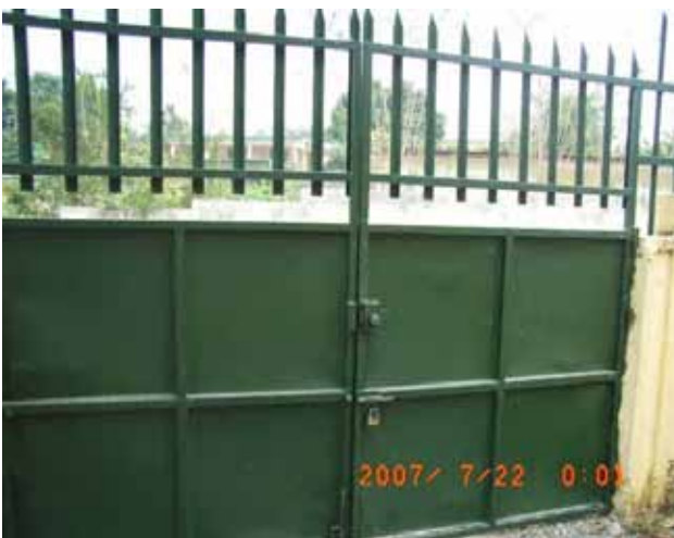
通用門内側の錠前
