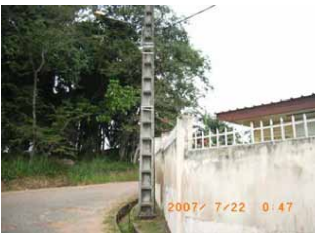
問題の足場となる電柱
