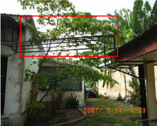
四角内、問題の洗濯室軒下から事務所軒下に取り付けられている鉄筋
