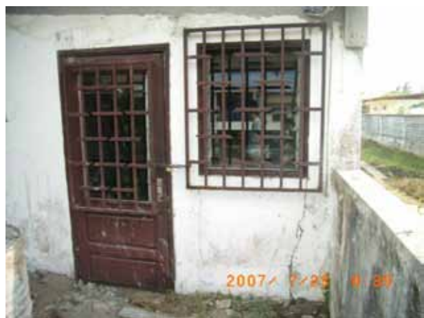
傷みが酷い玄関扉の木の枠
