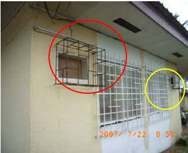
予備寝室と火村隊員寝室の外側 黄丸側火村隊員居室、赤丸内が問題のクーラー 取り外し口、鉄格子は細めで強度に欠ける
