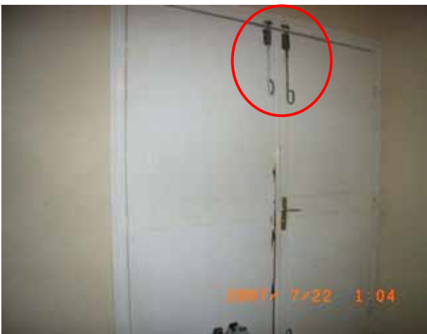
玄関の内側 上部差込の金具が脆弱
