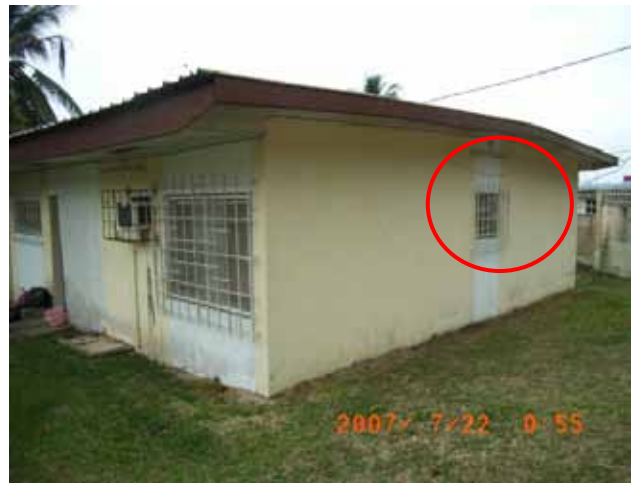
和木隊員寝室の外側 赤丸内専用シャワー・トイレ室高窓
