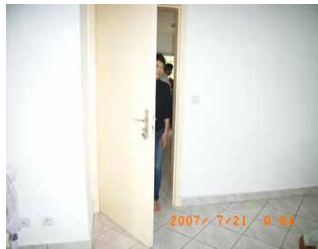
寝室の扉 両面シリンダー錠を取り付けている。
