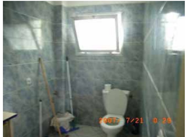
トイレの内倒し窓
