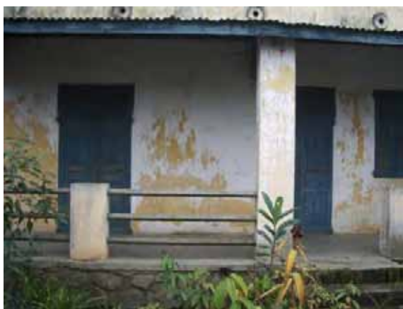
玄関側扉 扉を閉鎖し出入口は裏口を使用する。
