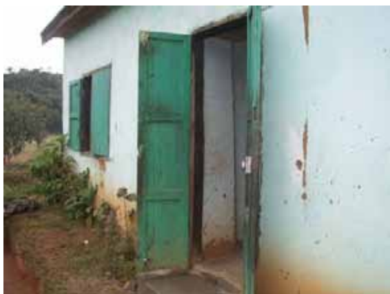
玄関の扉 シリンダー錠付きの両開き板扉で片側に差込錠を取り付けている。
