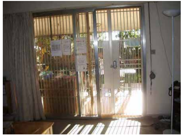
玄関扉の内側サムターン式テンキ錠 周囲に鉄板を張っているがサムターン回しの工具を使用すれば解錠できる。
