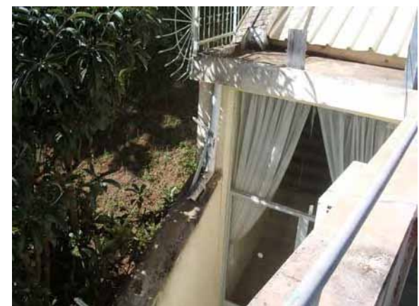
ガラス扉脇の塀 隣家との境の塀で立ち木を伝って侵入可能
