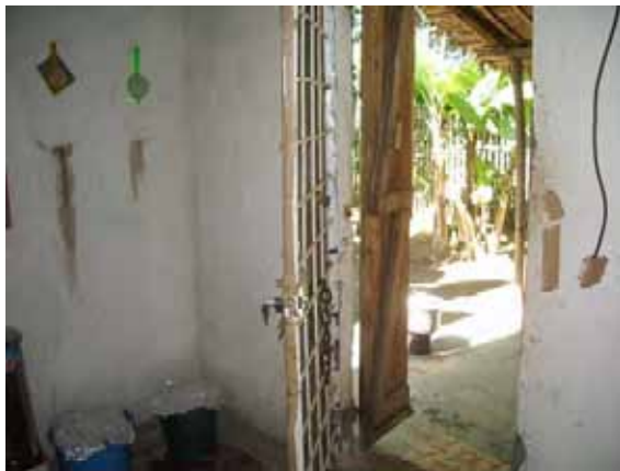
上記台所の裏口扉 外側は隙間だらけの片開き板扉で中 央部分に門棒をはめ込み鎖を巻き南 京錠で施錠している
