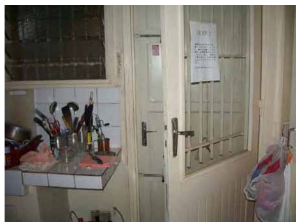
台所の扉 内側扉の棒錠錠は壊れている。
