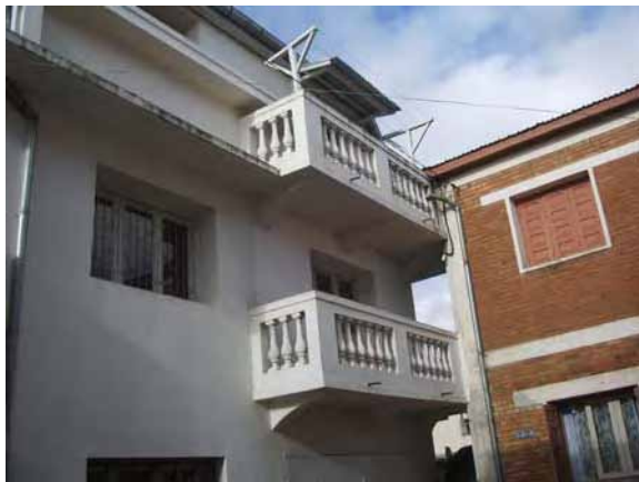
隣のアパートと接している 隣のアパートの鉄の配管が2・3階のテラスに接しており伝って侵入できる。
