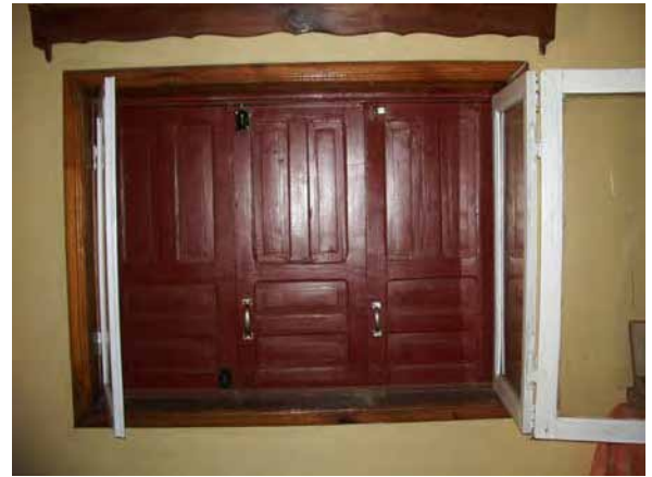
左同居間の窓 外側が3枚式の差込錠付き板窓で差込錠が細く更に差込部分が浅いため機能していない。
