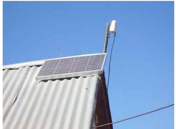
ソーラーパネルとイリジウムアンテナ
