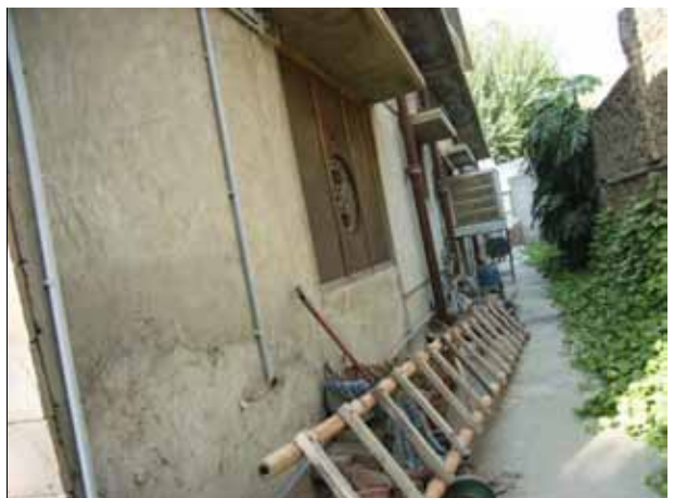
右隣家側通路 塀が低いため簡単に乗り越えることが出来、 梯子を使えば2階の窓にアクセス可能
