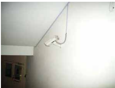
階段途中の監視カメラ
