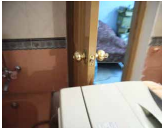
バス・トイレ室の扉の錠前は円筒錠 扉は湿気のためか閉まらない。
