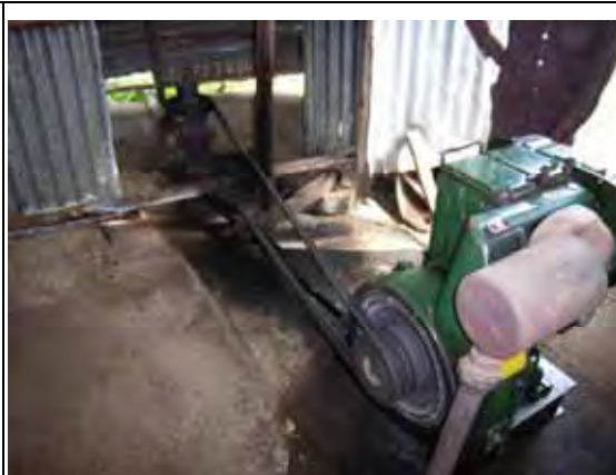
写真-2：地下水位の低い箇所が多く利用されているモノポンプとリスターエンジン
