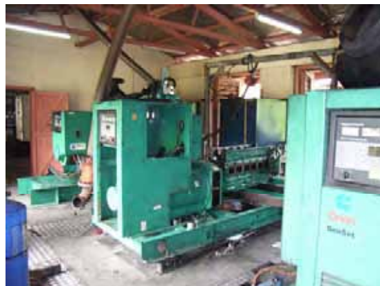
写真-11. Auki 手前 2 台が運転停止中
