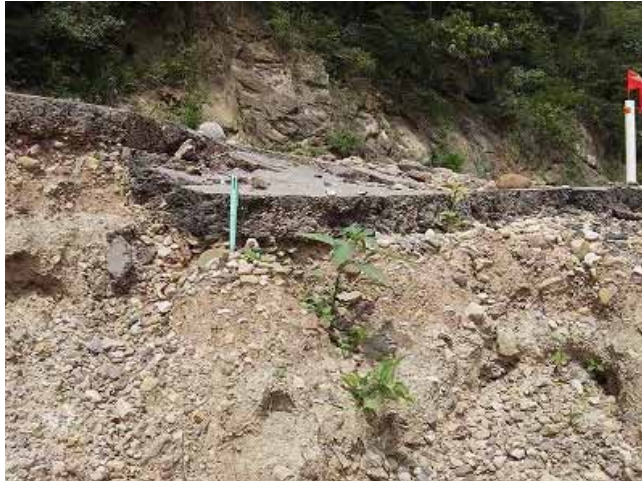
Foto 9.7.9 Depresión en la parte superior del deslizamiento
