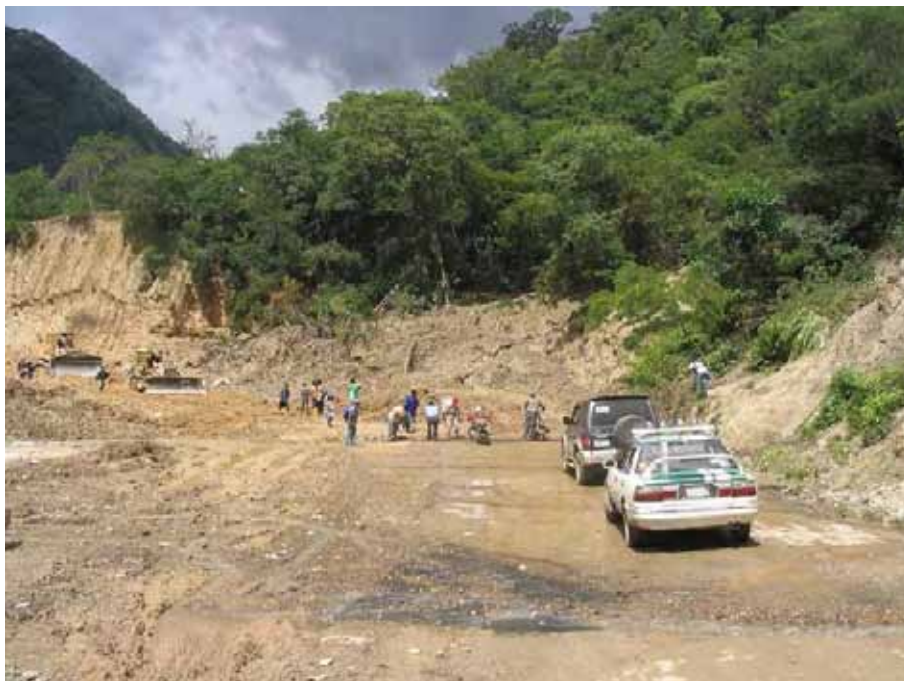
Foto 9.13.3 Carretera dañada por mazamorras (en rehabilitación)
