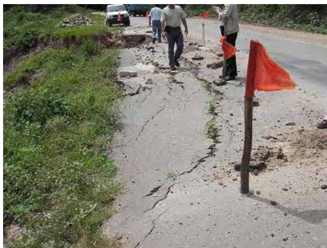
Foto 9.7.8 Fisuras abiertas en la parte superior del deslizamiento
