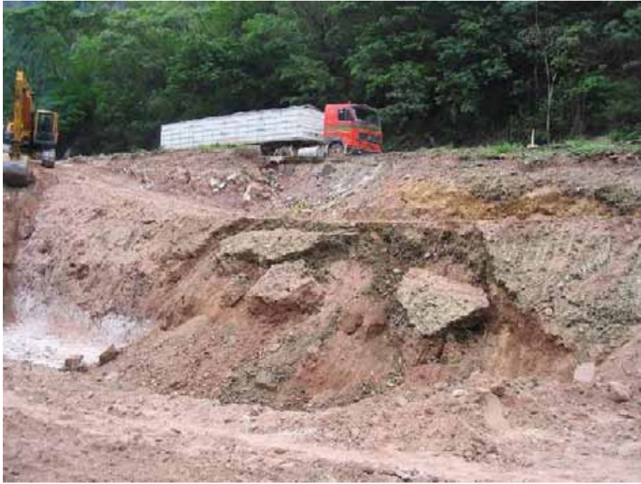
Foto 9.11.1 Derrumbe causado por mala ejecución del terraplén original
