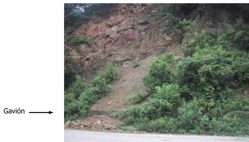
Foto 9.7.4 Gaviones y fragmentos amontonados de rocas caídas
