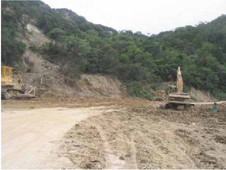
Foto 9.13.4 Carretera dañada por mazamorras (en rehabilitación)
