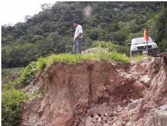
Foto 9.7.10 Erosión secundaria por el agua de drenaje
