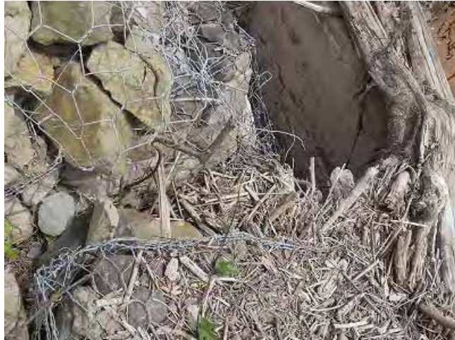
Foto 9.7.12 Abertura del gavión por la compresión lateral
