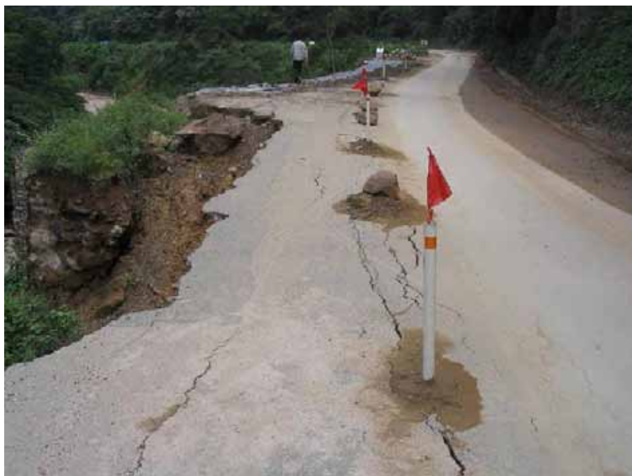
Foto 9.13.2 Derrumbe de la plataforma por el agua lluvia (2)
