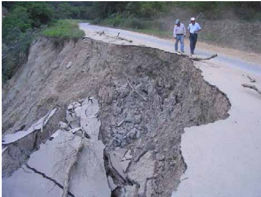
Foto 9.13.1 Derrumbe de la plataforma por el agua lluvia (1)
