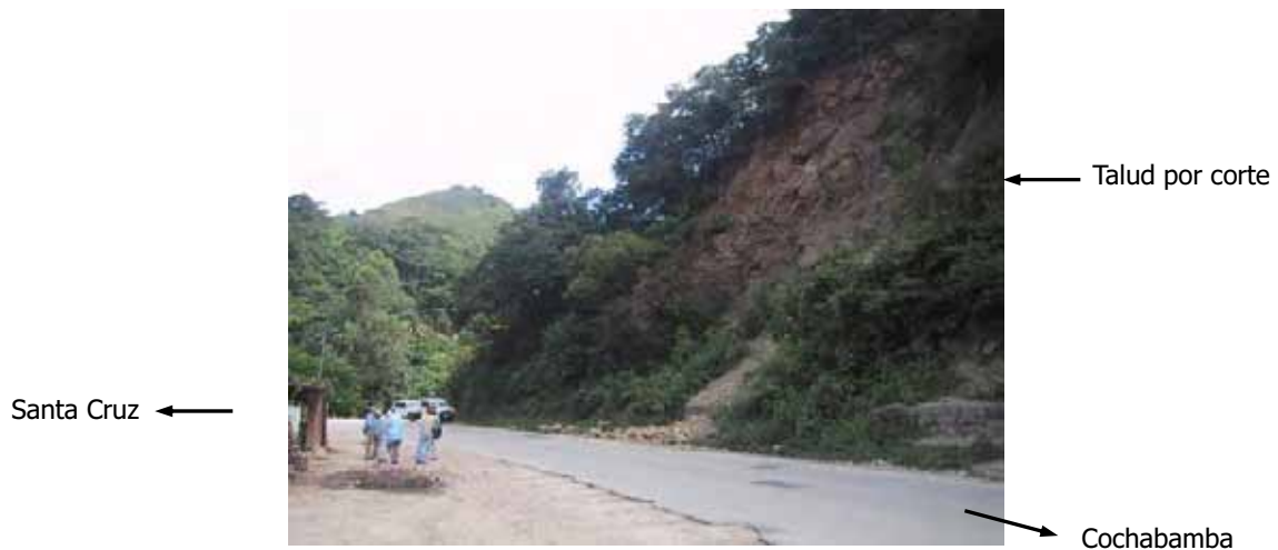
Foto 9.7.3 Precipicio con la caída de rocas y la Ruta 7
