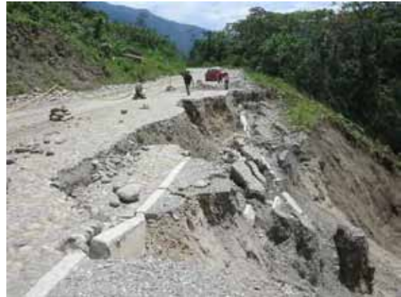
Derrumbes típicos en la Autopista Nacional No.4
