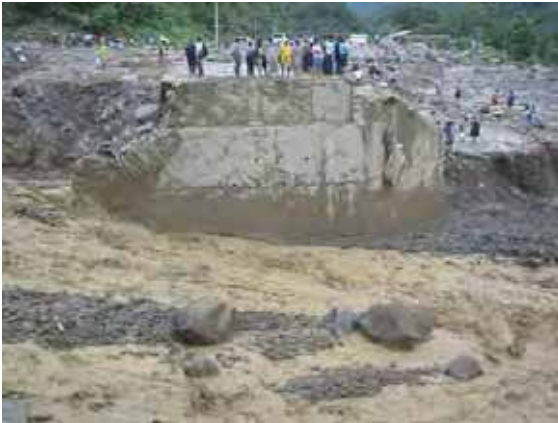
Estado del puente Thiyumayu luego del desastre ocurrido el 27 de octubre de 2005
