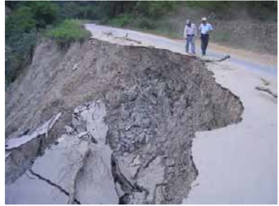
路面排水不良による盛土崩壊現場 国道7号線ベルメホ地区(2007年2月)
