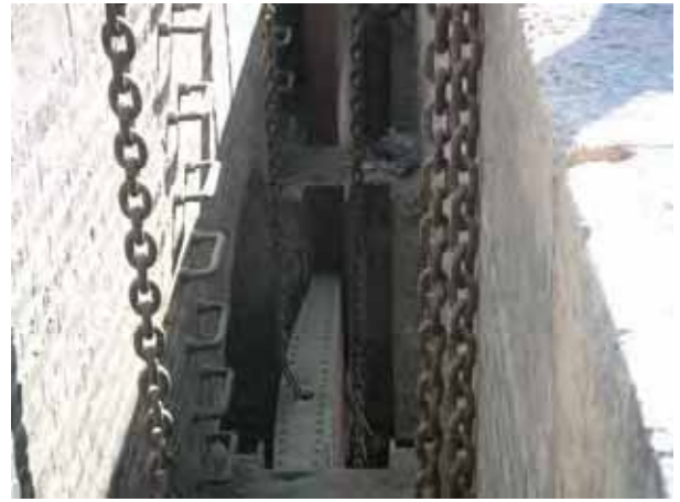
写真-8：既設ゲート吊状況接写。各ゲートはチェーン一本で吊下げられており、開閉時は不安定且つ大きな力がチェーンに作用し、チェーンの破断のため操作不能のゲートもある。
