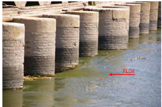
写真-2：既設ダハブ堰上流側より撮影。堰柱部レンガは風化し、モルタルの剥げ落ち、破損が目立つ。
