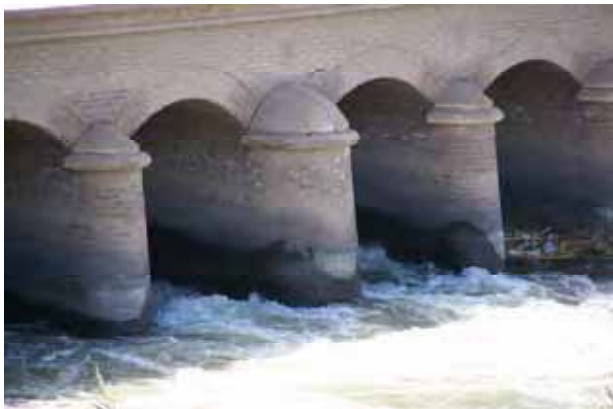
写真-3：既設ダハブ堰下流側より撮影。流速の速いアンダーフローで放流しているため、水面が激しく泡立っており、下流側河床の洗掘を生じている。
