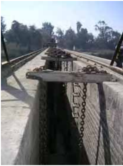
写真-7：既設開閉機走行レール及び既設ゲート吊状況。各ゲート真上に開閉機を移動させて開閉を行うため操作開始までに時間を要し、円滑操作の妨げとなっている。
