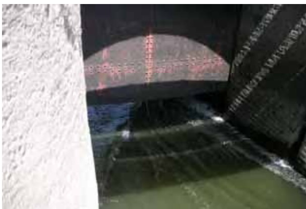
写真-5：既存ゲートの表面は、腐食に伴う錆びが何え、ゲートの強度低下を生じている。
