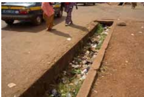
道路側溝の状況(Route le Prince)
