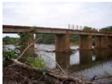
転落防護柵の欠落
