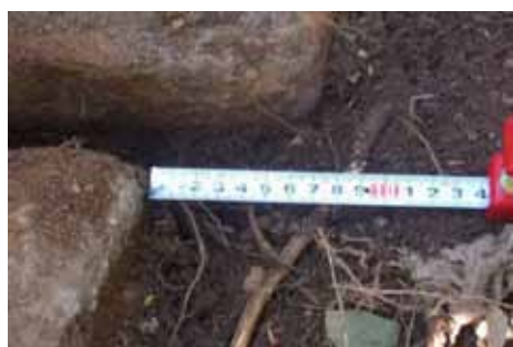
橋梁本体と橋台のずれ
