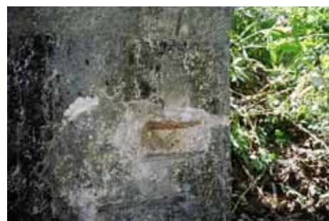
橋台部に見られる鉄の露出
