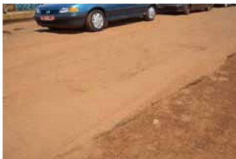
1.9km 付近の舗装の沈下
