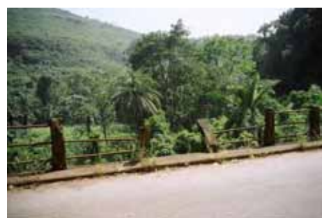
破損し放置されたままの高欄
