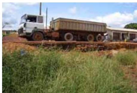
洗掘された路肩(3.5km 付近)
