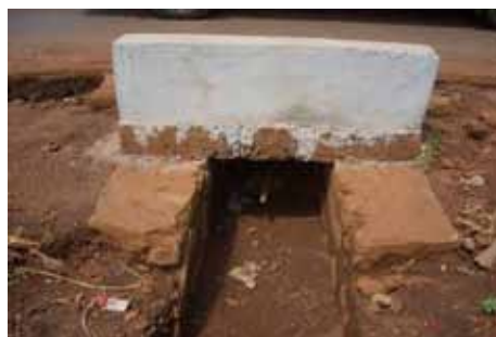
メンテナンスされていない排水施設(2.7km)
