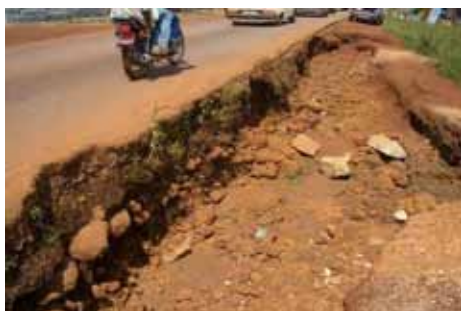
洗掘された路肩(3.2km 付近)
