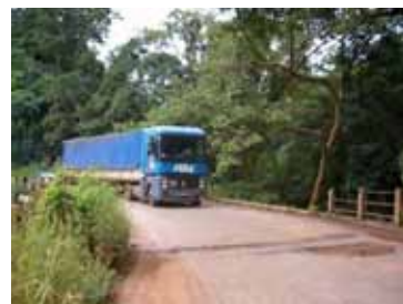
大型車両の通行・欠落した防護柵
