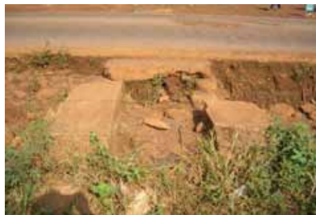
排水施設、ポットホール(4.5km 付近)
