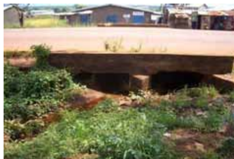
排水施設 Box Culvert(3.0km 付近)
