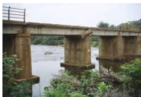
橋脚に残された流木の残骸
