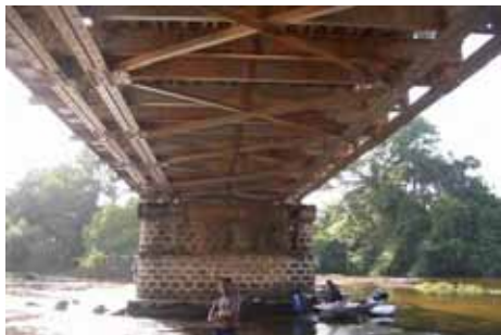
錆の発生状況
