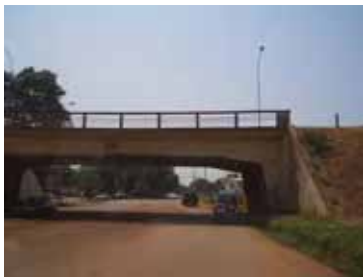
大型車の衝突による桁の破損
