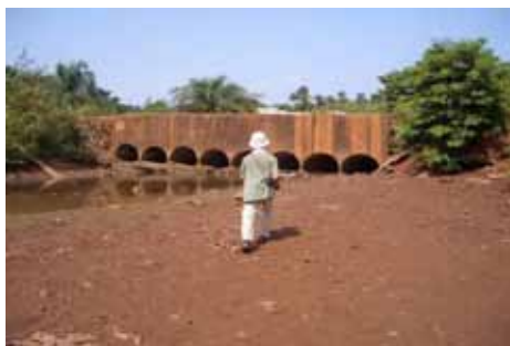
排水施設(6.0km)
