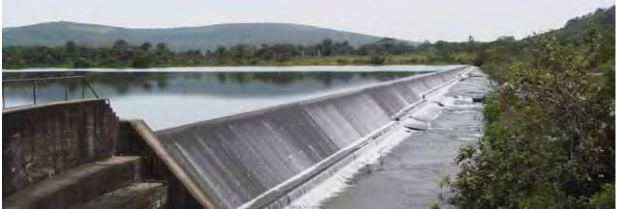
Barrage des Grandes Chutes (Source d'eau de la ville de Conakry) Capacité de la retenue: 2,000,000m 3
