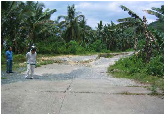
元河川に道路施工、洪水で破壊 (南サマール)
