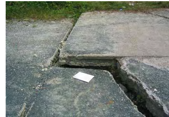
鉄筋が皆無のため破壊
