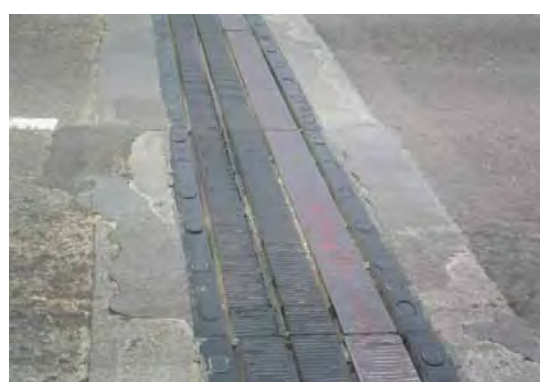
伸縮継ぎ手は損傷あり。(Rarion 橋)
