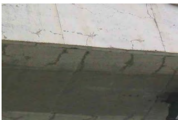
横梁にクラックが見られる。
