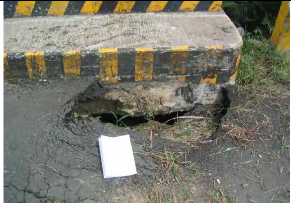
土砂流出により陥没
