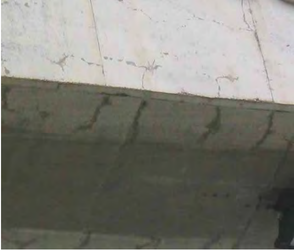
同橋のクラック
