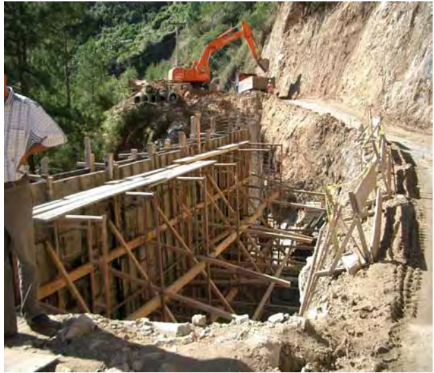
DPWH コルディレラ行政リージョン（CAR）事務所（バギオ市在）管内の道路の様子①
