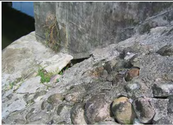
レイテ地方橋梁、石張工損傷し土砂流出
