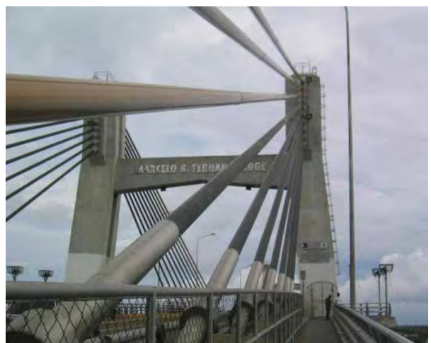
リージョンVII事務所管内にある第2マクタン橋の主塔
