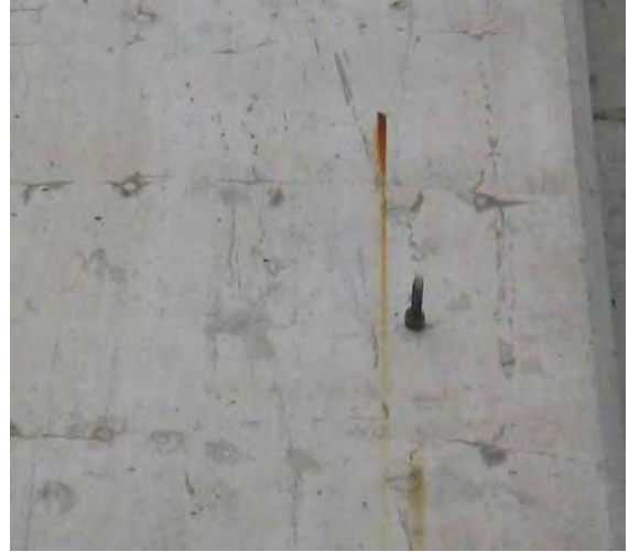
同橋に錆汁が見られる。
