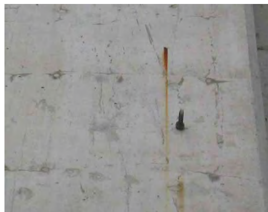
錆汁が出ている。
