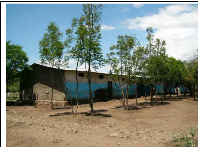
写真 1 5 : 妻側の塗装が補修されていない土壁校舎
