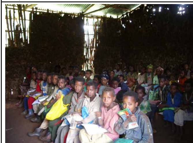
写真 27 : 土壁が崩れ、床がなく、家具が不足している教室 Sabaallee (Kuni Wareda, Herarge West Zone) WH2-2
