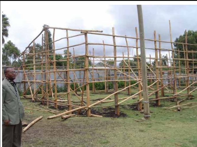
写真 1 4 : 建設に着手したばかりの土壁校舎。基礎がなく柱を地面に直接立てた掘建て造りになっている
