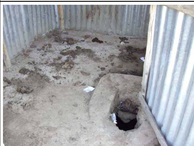
写真 30 : 便器 (穴) 以外に用便をし、清掃されず衛生状態の悪いトイレ Uboo Weennii (Zuway Dugda Wareda, Arsi East Zone) EA2-5
