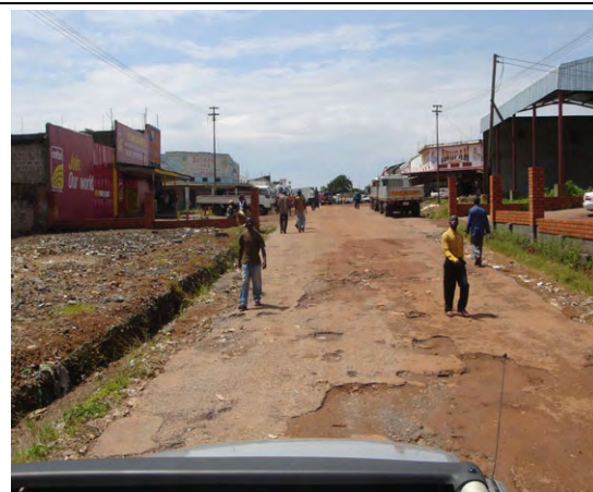
K4 ブランタイア道路 路面の全面破壊
