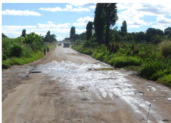
N8 チャンベシ道路 (舗装箇所) 横断排水不良による路盤破損
