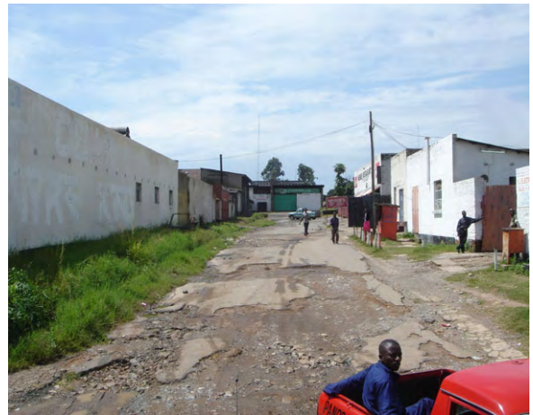
K5:エショワ道路 舗装の全面破壊
