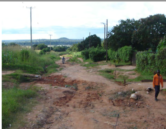
N8 チャンベシ道路 (土道箇所) 雨水排水による道路破損
