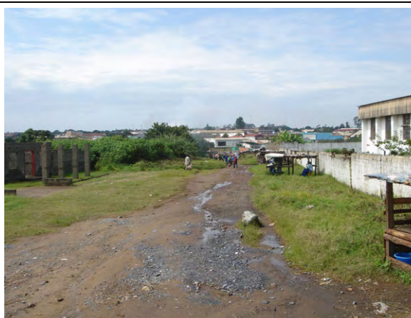
K1 ドクターアグレ道路 未整備部分の排水不良による道路破損
