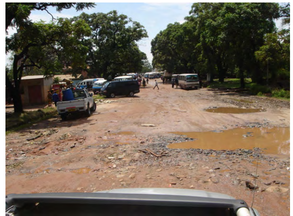
K6:マツカ道路 排水不良による道路の全面破壊
