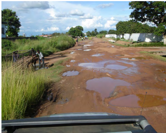
N7:ルカス道路 ポットホールによる道路全面破損
