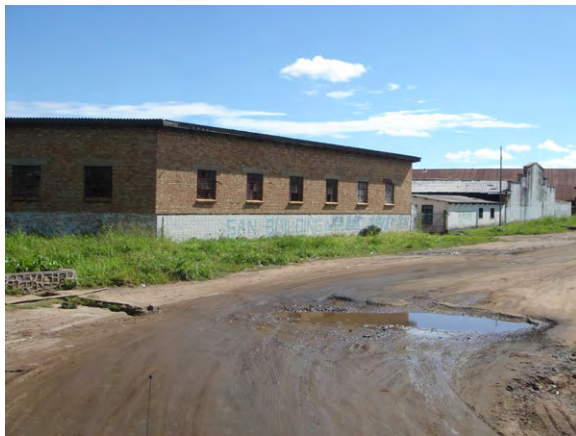
N9:リビングストーン道路 ポットホールによる路床破壊
