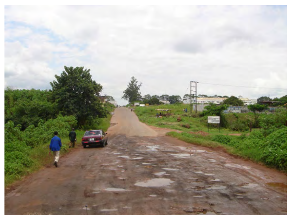
K8:ナトワング道路 排水不良のよる舗装破損
