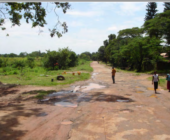
K7 カンタンタ道路 排水不良による舗装破損
