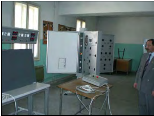
屋内配線実習室（カズィアンテップ校）
