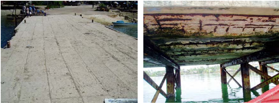
写真-1 既存棧橋の劣化状況
